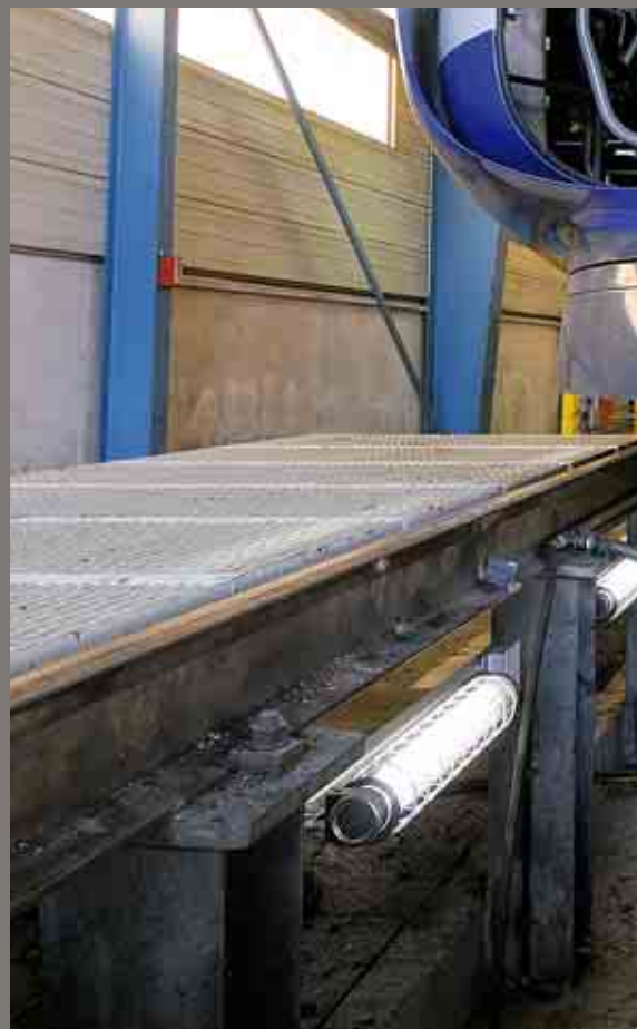
SNCF, VILLENEUVE-SAINT-GEORGES/FRANCIA – FOSOS DE REVISIÓN SNCF, VILLENEUVE-SAINT-GEORGES/FRANCIA – FOSSE ISPEZIONABILI
